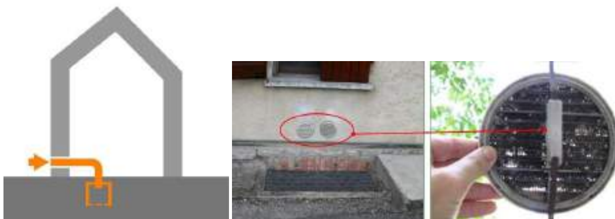
Figure 23 e 24: necessità della manutenzione dei punti di aspirazione dell'aria
